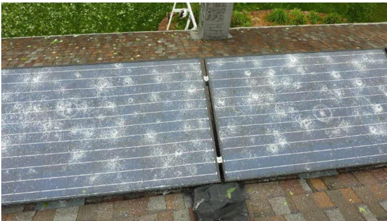
Рисунок 7. Повреждение панелей градом. Канберра 2020 год.
