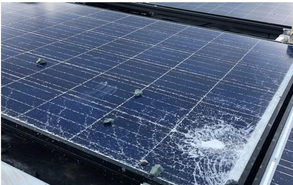
Рисунок 6. Повреждение панелей камнями.
