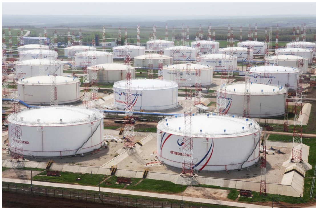
Рис.1 – Резервуарный парк для хранения нефтепродуктов
