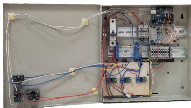
Фото 6 – Щит управления всей системой
