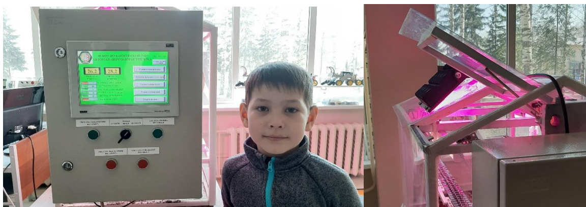
Щит автоматического управления теплицей с сенсорной панелью и открывающееся окно
